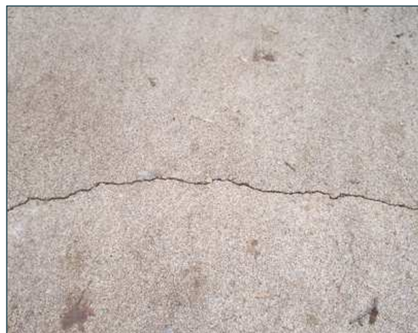
Aperçu détaillé d'enrobé à liant végétal Apparition d'une fissure
