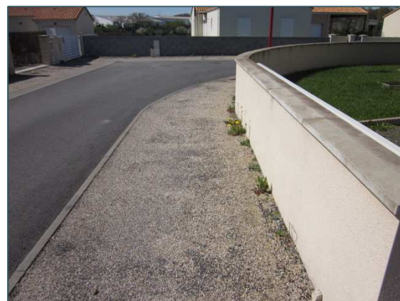
Apparition du liant (bitume) et de végétaux
