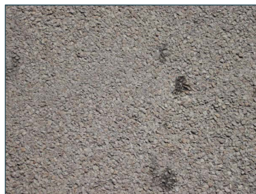
Aperçu détaillé d'enrobé coloré avec tâches d'hydrocarbures
